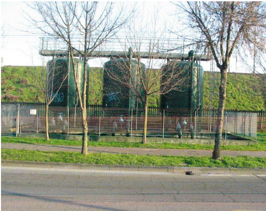
Pozzi 2 e 3 Filtri di depurazione a carbone attivo
