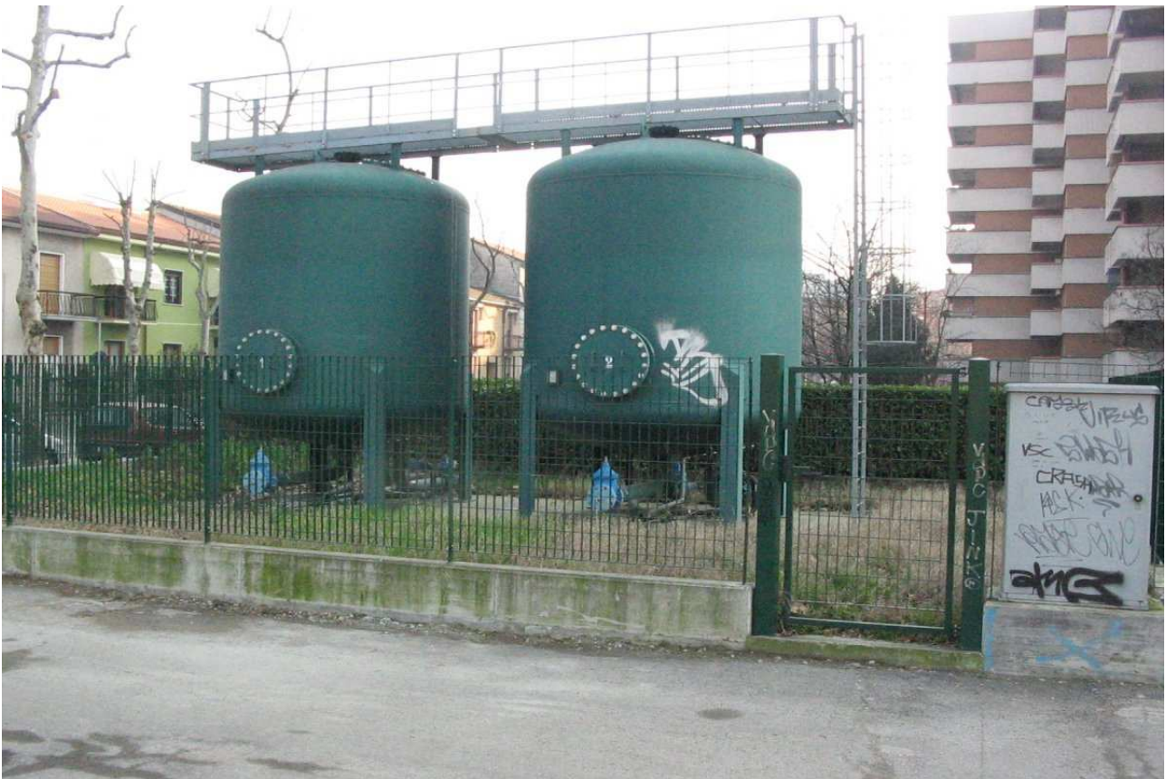
Pozzo 62 – Filtri di depurazione a carbone attivo
