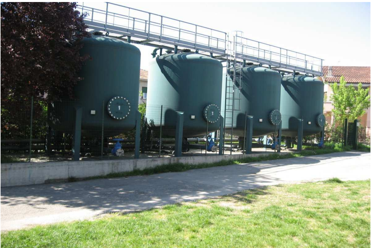
Pozzi 1 e 11 Filtri di depurazione a carbone attivo
