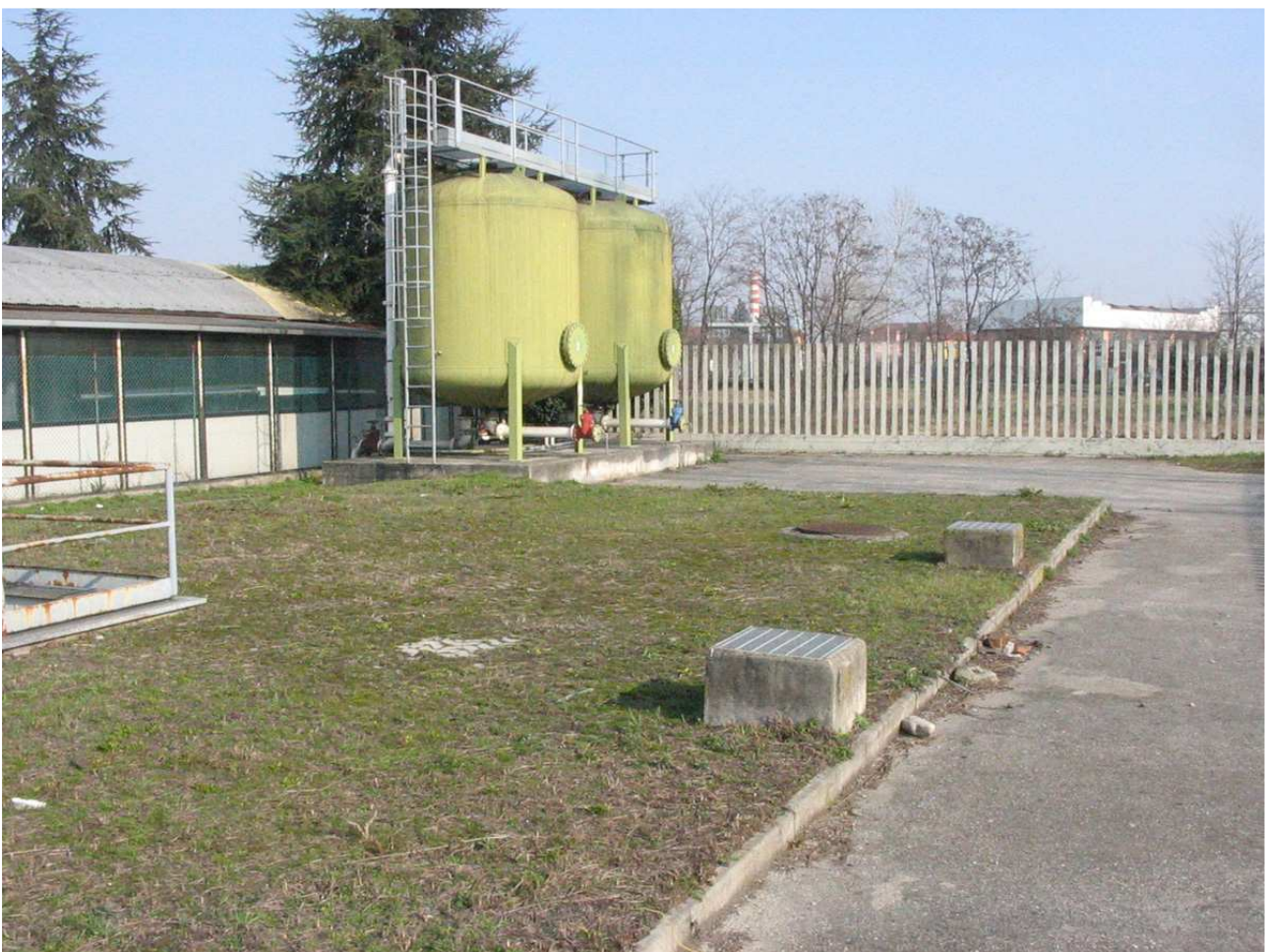
Pozzo n. 69 con i filtri di depurazione a carbone attivo – vista da ovest
