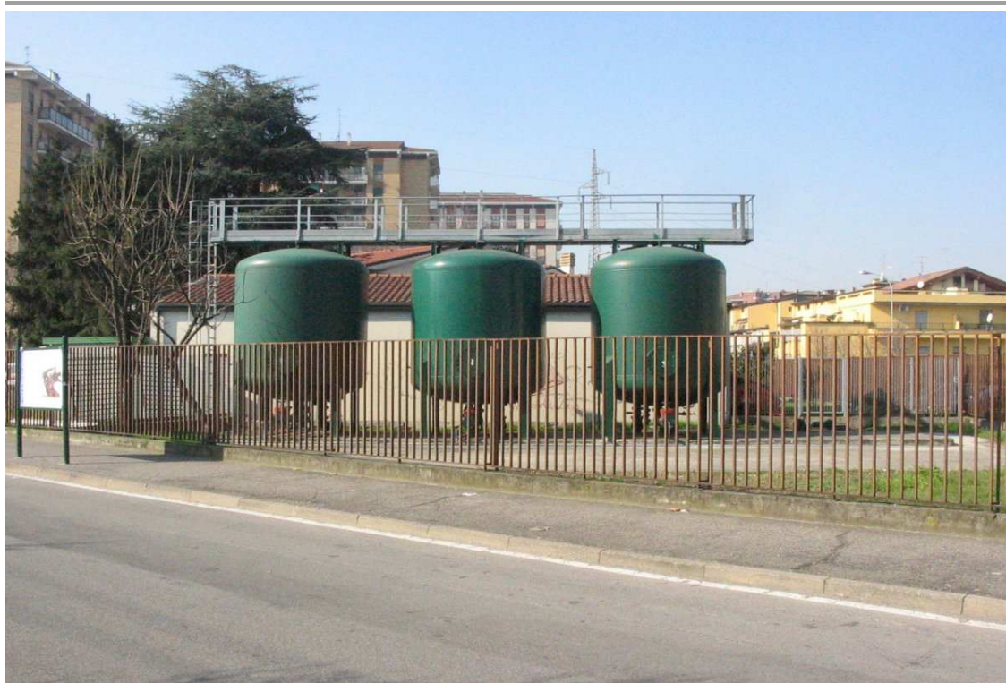
Pozzi 6 e 7 Filtri di depurazione a carbone attivo
